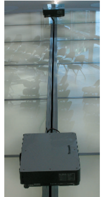
Schiene zur flexiblen Positionierung der Projektoren im Veranstaltungssaal
