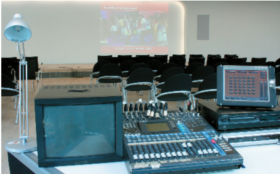
Arbeitsplatz bei technisch betreuten Veranstaltungen mit Yamaha 01V und Touchpanel der inSynergie-Mediensteuerung
