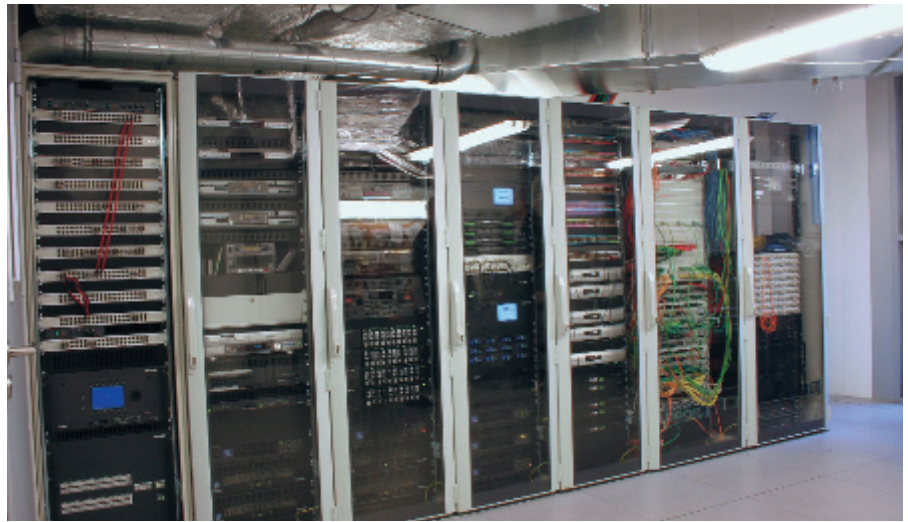
Geräteschränke im zentralen Technikraum
