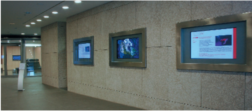
Bereits von außen können sich Passanten informieren – über drei 42" große Plasma-Displays und Lautsprecher in der Decke.
